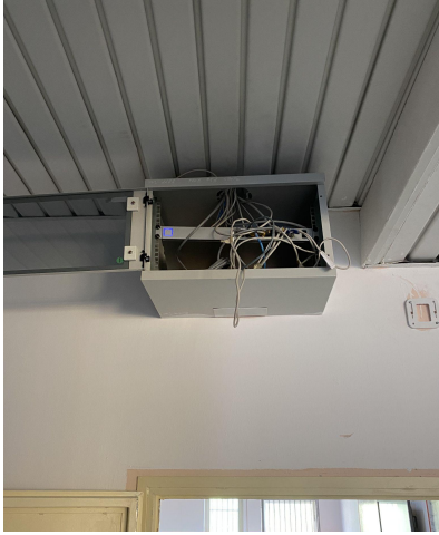
Rack primo piano collegato su altri rack di laboratorio raggiunti in cascata
