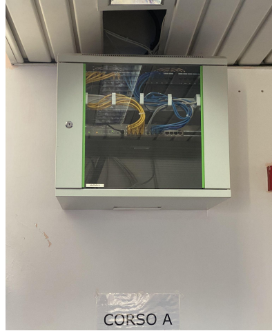
Rack primo piano per AP Wi-Fi per l'intero edificio
