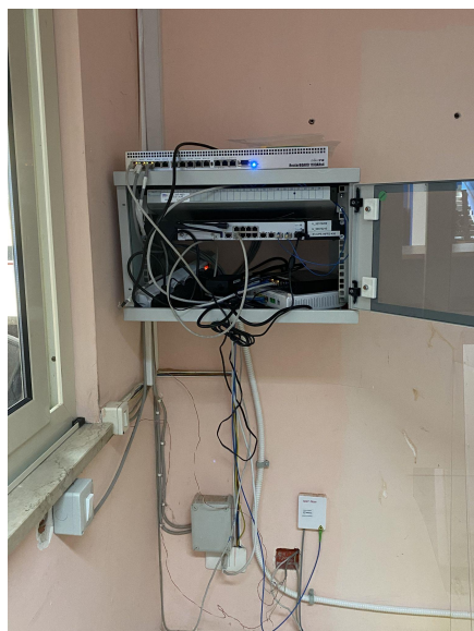
Rack di centro stella di edificio
